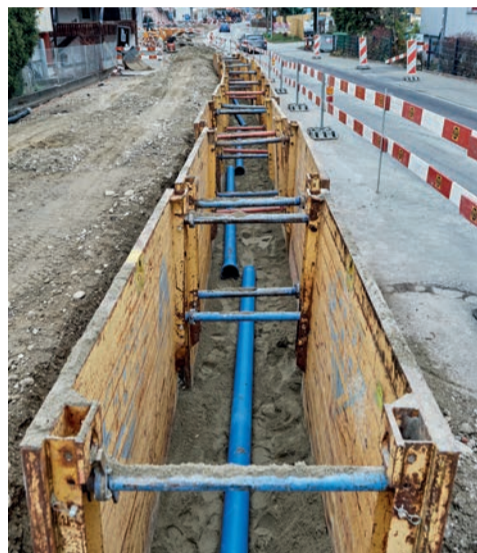
Toutes les conduites industrielles d'eau, d'électricité, d'eaux usées et de télécommunication sont assainies.
